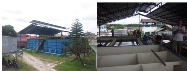
写真2. 水道会社の水処理ユニットの一つ
