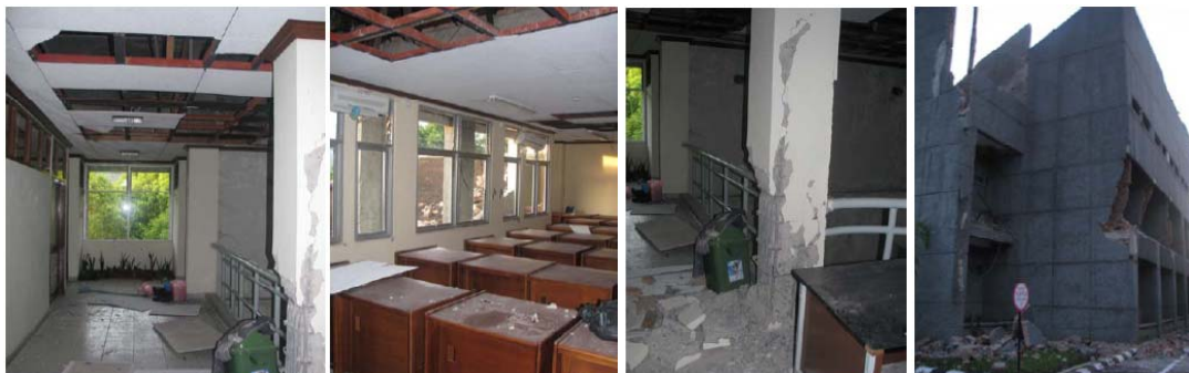
左から理数学部生物学教室の被害状況(左 3 枚の写真)と全壊した工学部棟(右端の写真)
