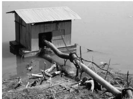
図2. 汲み上げポンプ
